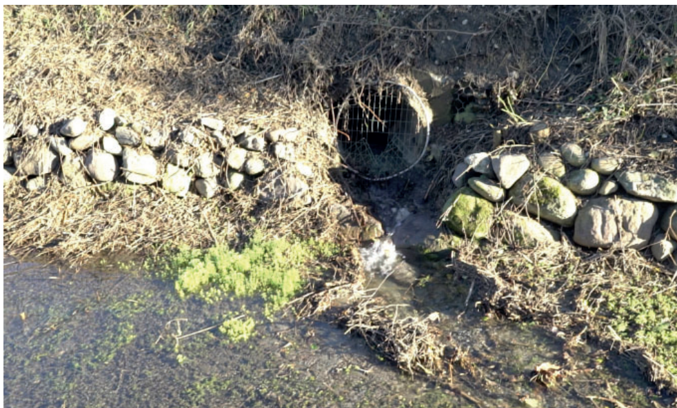
Fig. 22. Tubo proveniente dall'Oglio e che si immette nell'Ogliolo nei pressi del ponticello del Hintirì de la Ö ; in seguito alle abbondanti piogge di inizio novembre 2023 e al conseguente innalzamento dell'Oglio, dal tubo fuorusciva acqua
